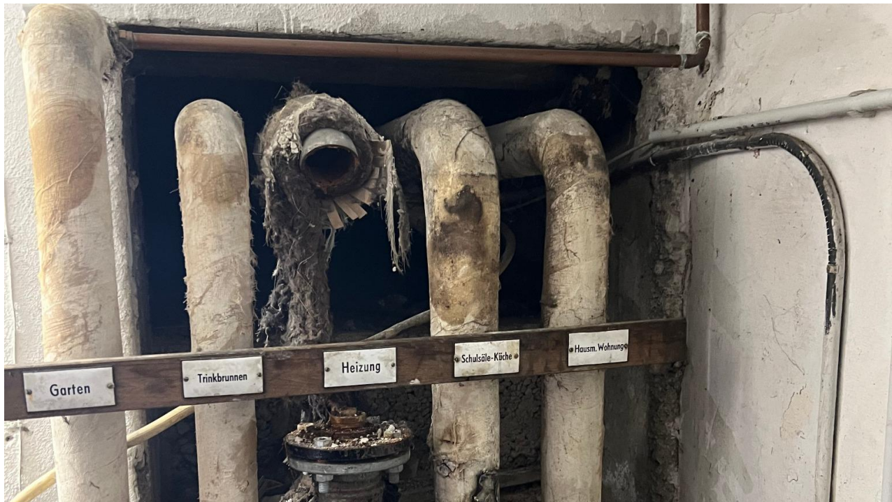
Bestandsaufnahme vor Ort: Beschriftungen helfen – ersetzen aber keine technische Prüfung.
